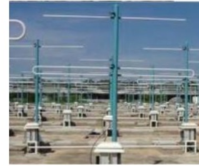
1 kW VHF TRMs: NARL (MST Radar)
